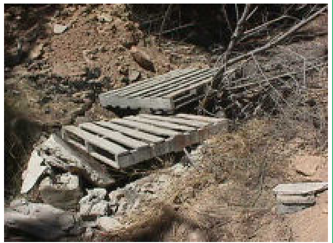
Fossa sèptica oberta al mig del carrer
